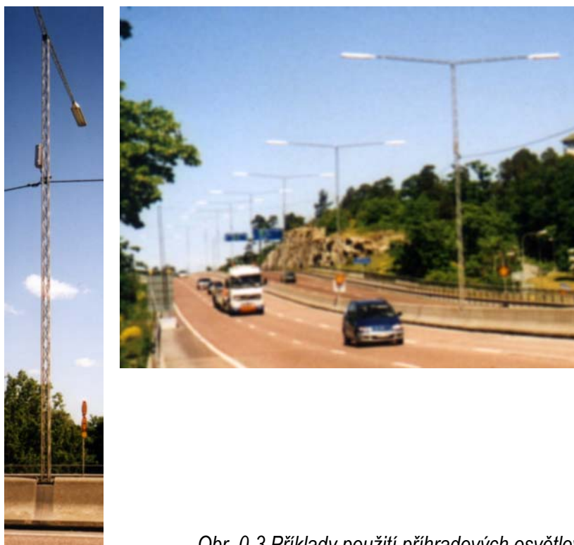
Obr. 0-3 Příklady použití příhradových osvětlovacích stožárů
